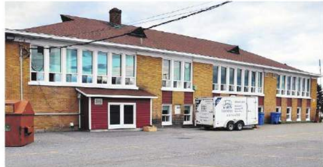
L'école de l'Anse tentera de se débarrasser définitivement de ses problèmes de moisissures et d'infiltration d'eau. (Photo TC Media - Dominique Fortier)
